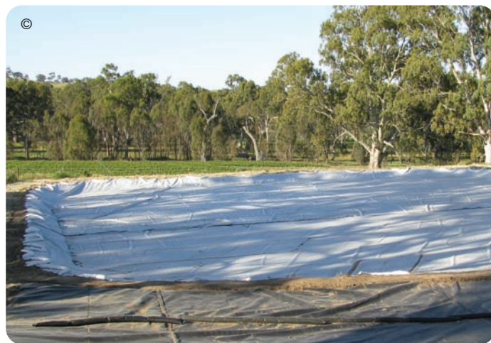
Cubierta VapourGuard instalada por Fabtech
